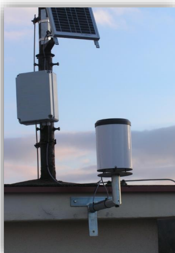
Srážkoměr na střeše budovy
