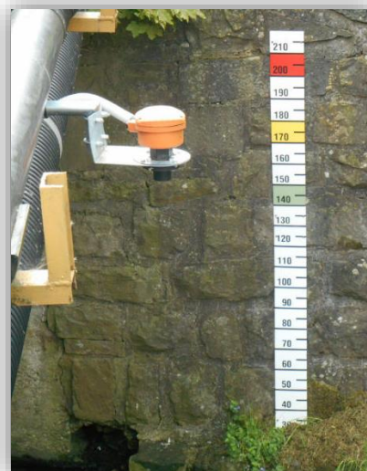
Hladinoměr s vodočetnou latí a vyznačenými stupni povodňové aktivity
