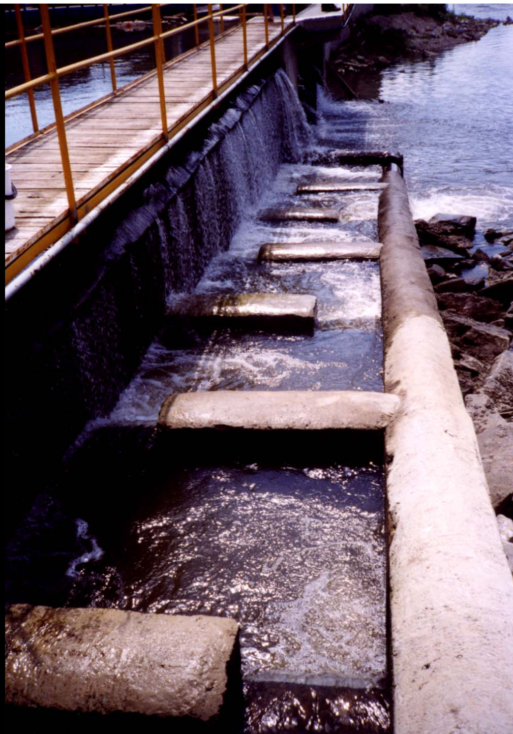
Technický přechod štěrbinový
